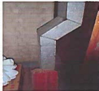
Bilde 3: Det er ført ventilasjonskanaler gjennom etasjeskiller, uten bekreftet brannmotstand.
