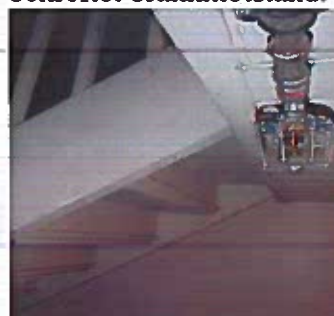
Bilde 6: Det er installert automatisk sløkkeanlegg i kjeller og trapperom i Kirkeveien 78. Det foreligger imidlertid ikke dokumentasjon for kontroll og vedlikehold.
