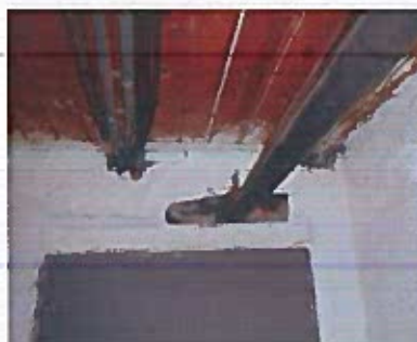
Bilde 5: Rør og kabler som er ført gjennom seksjoneringsvegg i kjeller har ikke nødvendig tetting.
