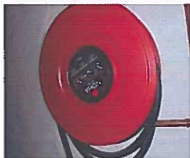
Bilde 7: Det er installert brannslanger i kjeller på objektene. Det foreligger imidlertid ikke dokumentasjon for kontroll og vedlikehold.
