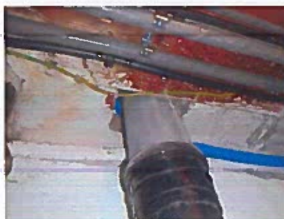
Bilde 4: Rør som er ført gjennom etasjeskillet mellom kjeller og overliggende etasjer, har ikke har ikke nødvendig tetting.
