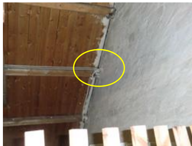
Loft: Hull må tettes.
