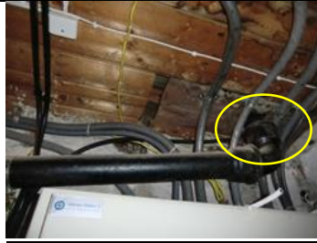
Kjeller: Rør gjennom etasjeskille uten sikring.
