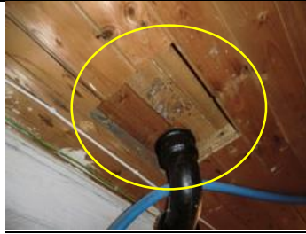
Kjeller: Svakheter rundt soilrør må utbedres.
