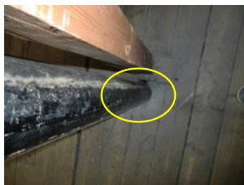
Svakhhet rundt rør, loft, tettes.
