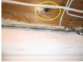
Kjeller: Hull må tettes.
