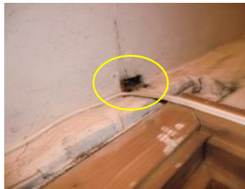
Kjeller: Hull må tettes.
