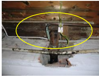
Kjeller: Svakhhet rundt soilrør må utbedres.
