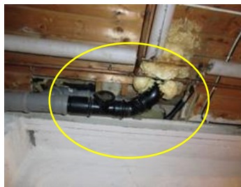
Kjeller: Plastrør gjennom etasjeskille uten sikring. Hull tettes.
