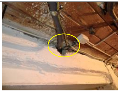
Kjeller: Hull må tettes.
