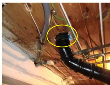
Kjeller: Rør gjennom etasjeskille uten sikring.
