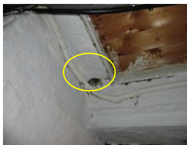
Kjeller: Hull må tettes.
