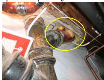
Kjeller: Svakhhet rundt soilrør må utbedres. Det virker til å være benyttet vanlig byggeskum som tettemiddel.
